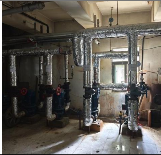
补水泵和循环泵
