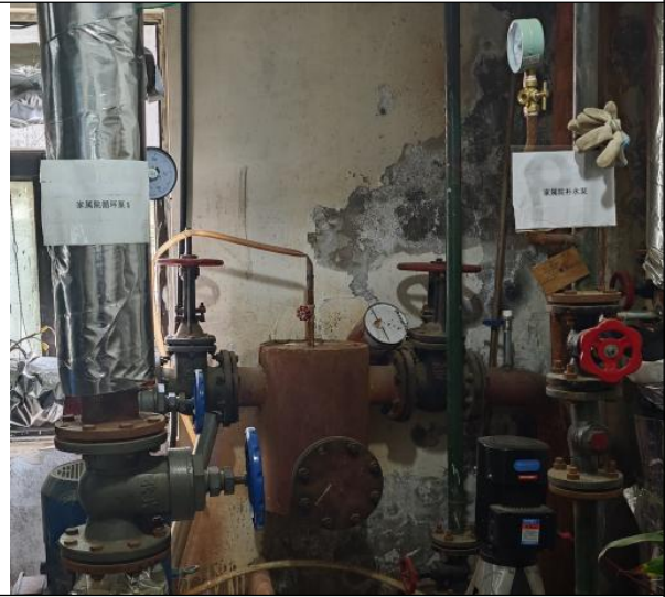
补水泵和循环泵配套仪表
