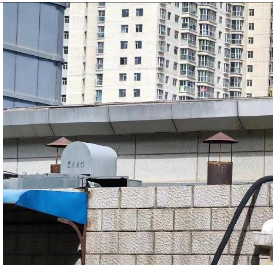
2根锅炉排气筒
