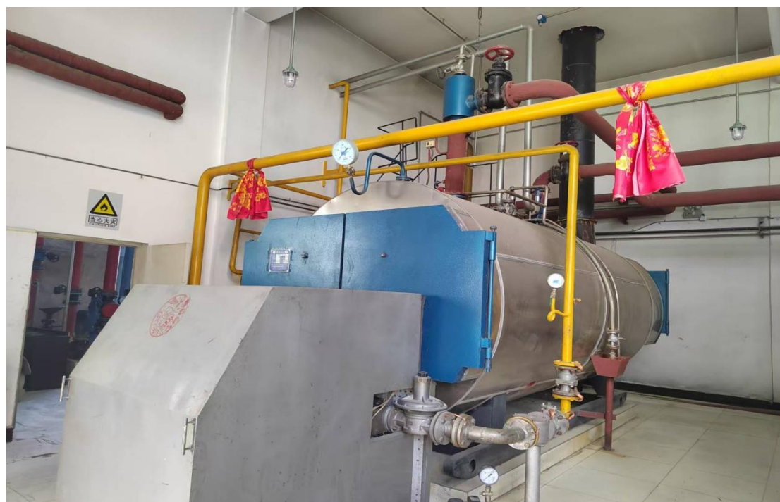
原锅炉和铭牌
