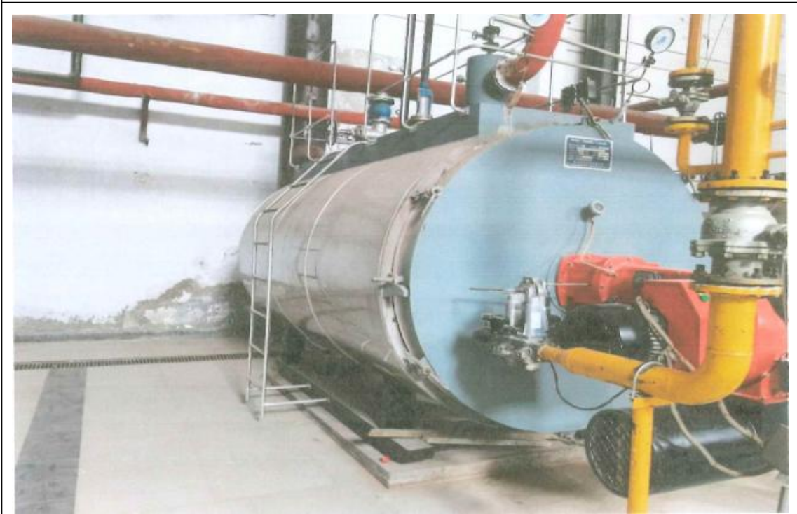
原锅炉和铭牌
