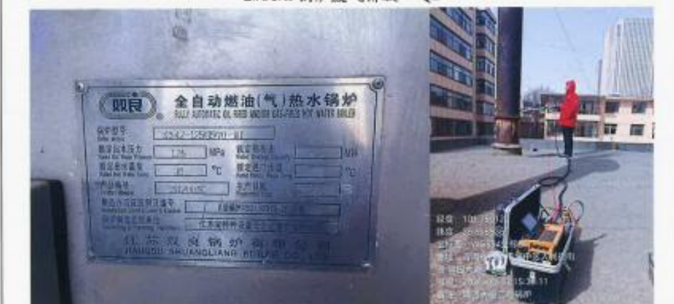
2#6T/h 锅炉废气排放口 Q2
